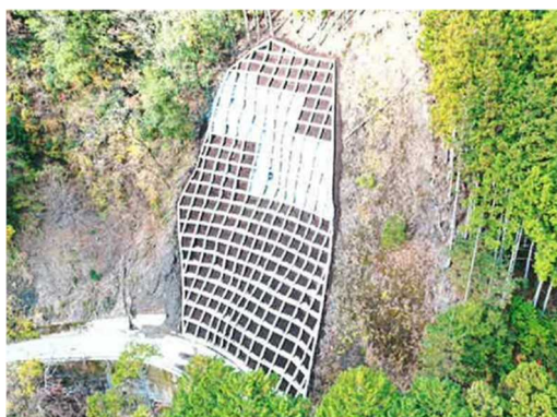
林道の落石・法面对策
