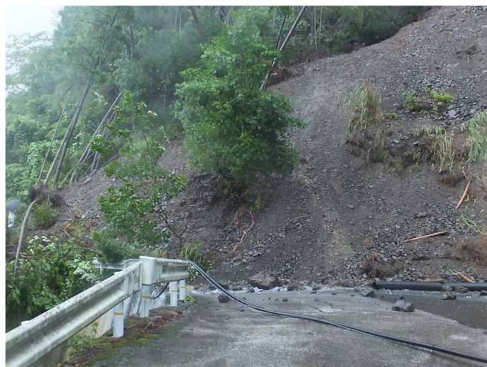
写真 2 土砂崩れが発生した林道亀ヶ峠線（平成 26 年 8 月豪雨）
