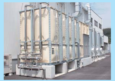
▲耐震性にも優れた受水槽
