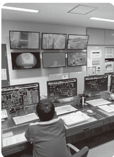
クリーンセンター制御室
