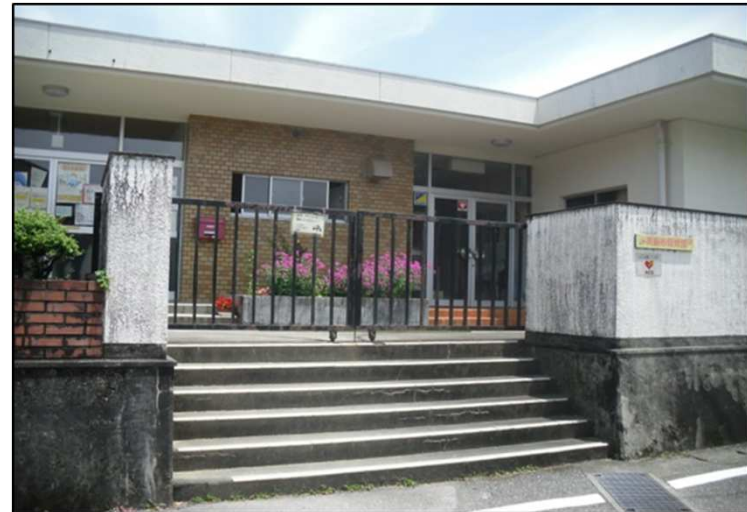
老朽化が進む美良布保育園現園舎
