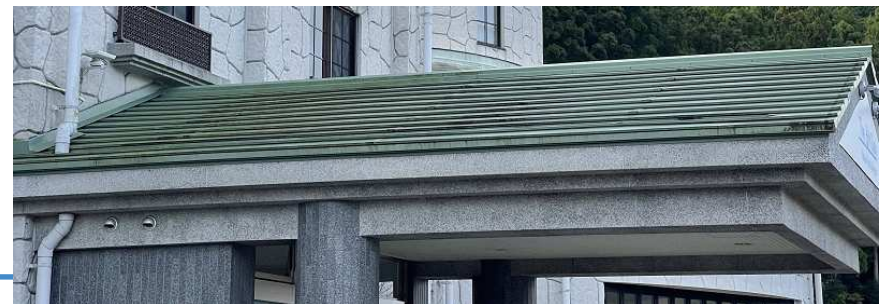
老朽化した屋根
