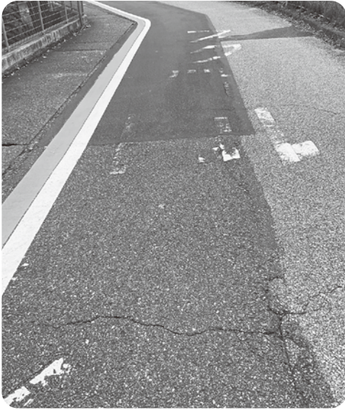
路面表示が薄れている箇所
