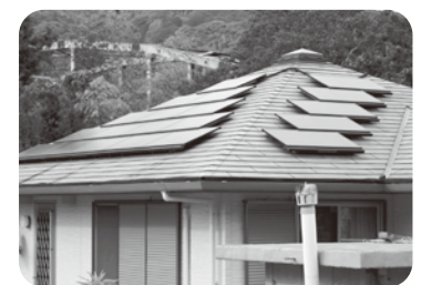
太陽光発電システム
