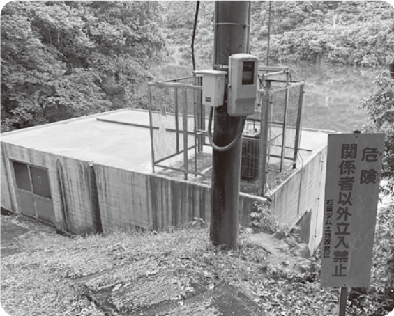
杉田土地改良区のポンプ施設
