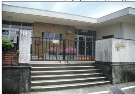
老朽化が進む 美良布保育園現園舎
