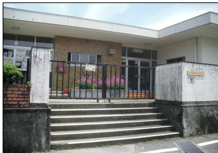
老朽化が進む美良布保育園現園舎
