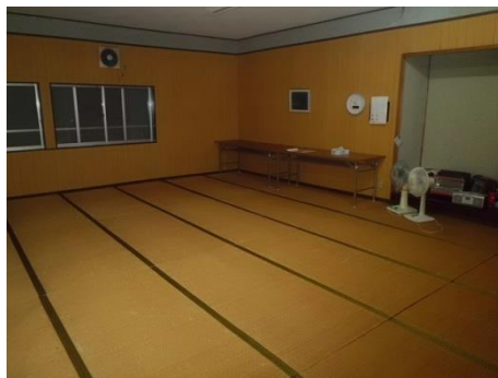
②集会室：ガラスの割れはないか、扉のゆがみがないか
