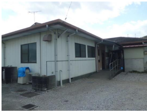
①外壁の落下、窓ガラスの割れはないか (施設全体を確認)
