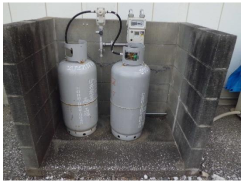
②ガスボンベが転倒していないか
