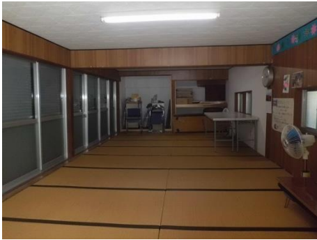
①集会室：ガラスの割れはないか、扉のゆがみがないか
