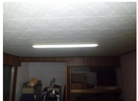
④集会室：照明に異常がないか
