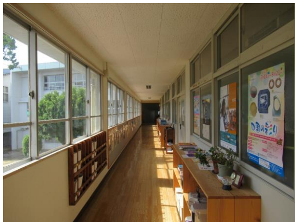
①廊下・教室：窓ガラスに割れはないか、 天井などの落下はないか確認
