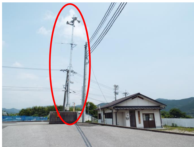
設置場所（写真）
