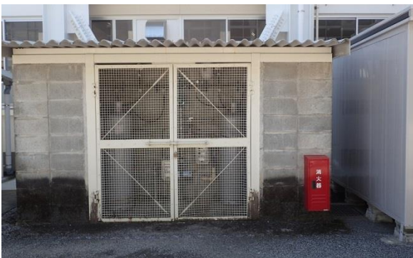
②LPガス ボンベが倒れていないか、ガスが漏れていないか（臭わないか）を確認する
