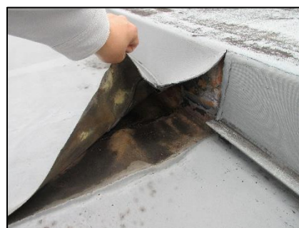
屋上防水シートのめくれ
