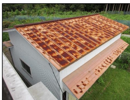
屋根葺き材の錆び付き
