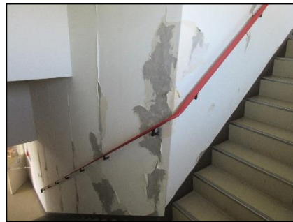
内装クロスの剥がれ
