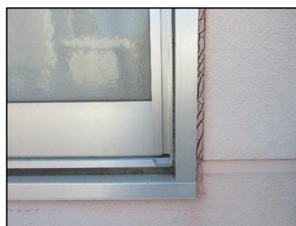
目地シーリングの亀裂・破断
