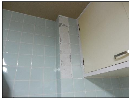
内装タイルの剥がれ
