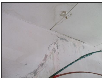
天井の雨漏れ・漏水
