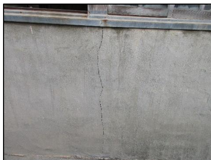
外壁のひび割れ・亀裂
