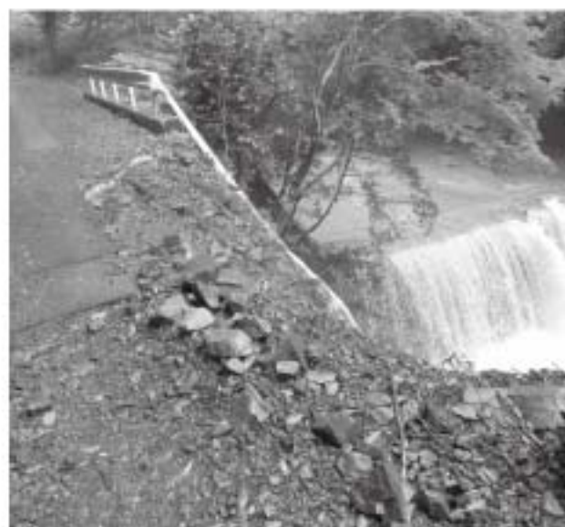
崩落した市道(物部町桑の川)
