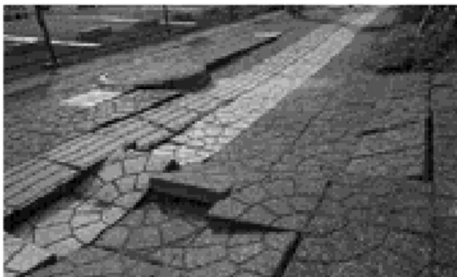
東日本大震災による下水道管被災状況
