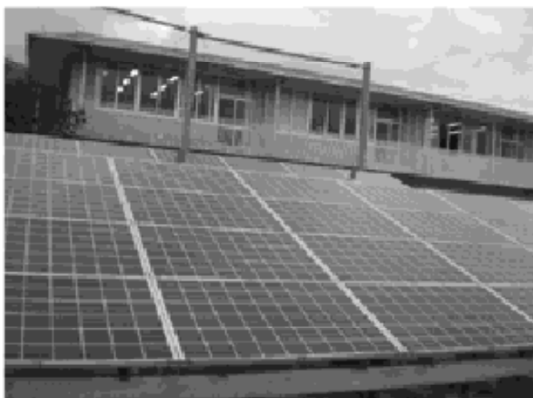
太陽光パネル（大宮小学校）
