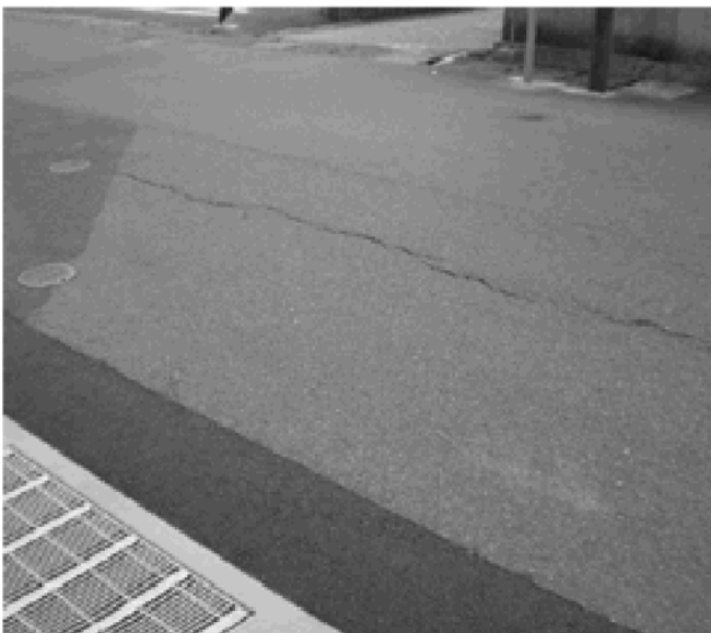
亀裂の入った市道(土佐山田町西本町)
