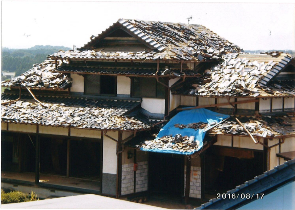
西原村 仮設住宅 被災家屋
